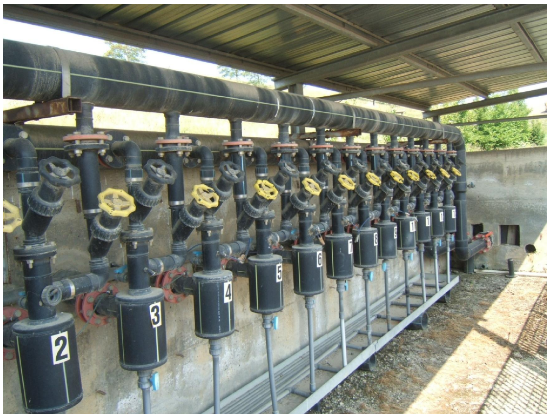
Figura 7-3. Particolare di sottostazione a servizio della discarica Chivasso 2.
