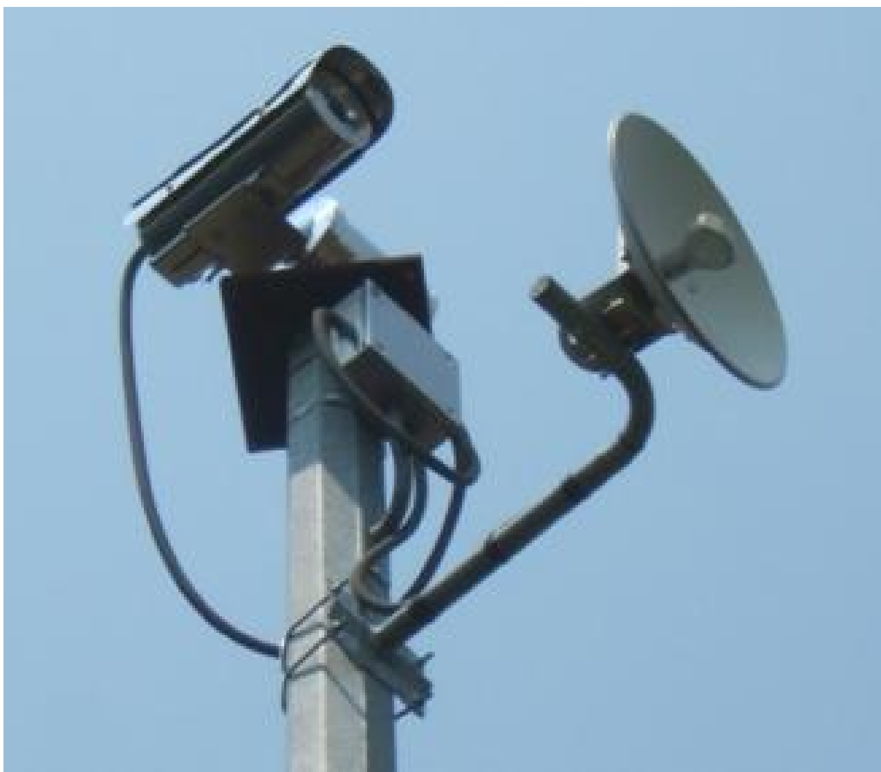
Figura 4-7. Vista di una delle termocamere attualmente installate sulla discarica
