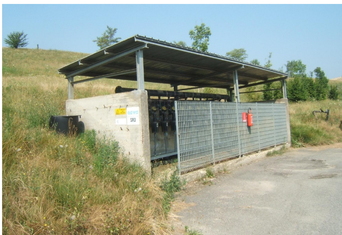
Figura 7-2. Esempio di sottostazione a servizio della discarica Chivasso 2.
